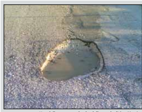
Una delle numerose buche della strada di San Martino
