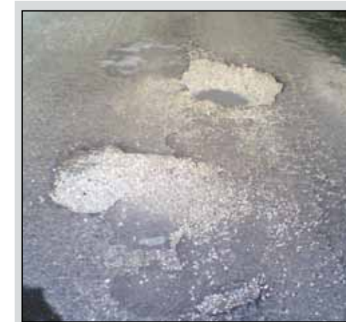
Buche della strada che collega via Partanna con l'autostrada
